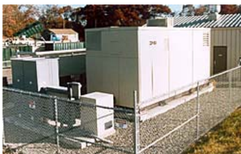
Centrale di cogenerazione con celle a combustibile PAFC
