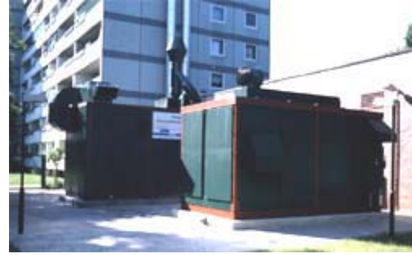
Centrale di cogenerazione con PAFC in un quartiere residenziale di Amburgo
